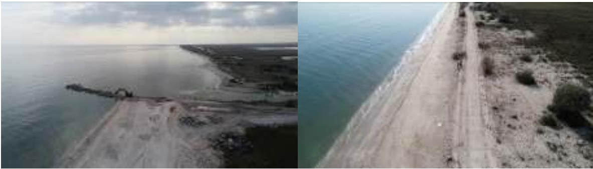
Figura II.200 Lucrări de reabilitare a digului Edighiol și a drumului acces Edighiol-Periboina care a afectat habitatul 1210 - Vegetație anuală de-a lungul liniei țărmului
